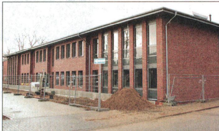
Die Tostedter Schüler können mit Beginn des kommenden Schuljahres die Räume an der Poststraße beziehen Foto: kb Nordkeide WB 1.2.2012
